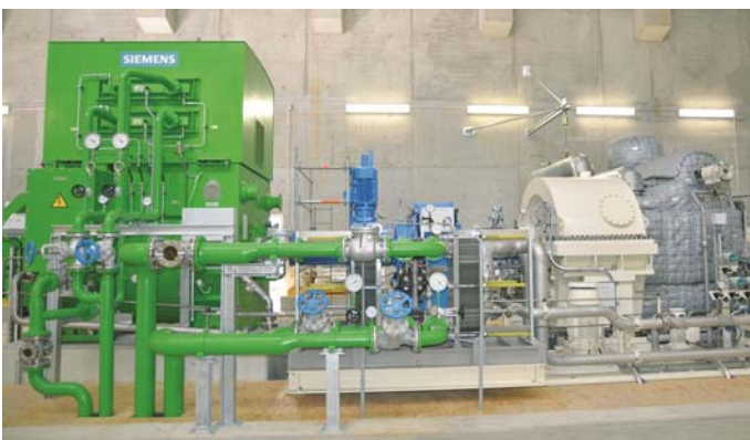
Das Herzstück der Anlage – hier wird die bisher ungenutzte Abwärme mittels einer Turbine und eines Generators in Strom umgewandelt
